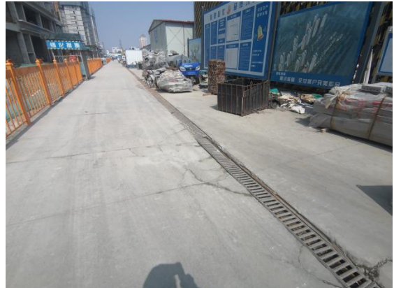
临时排水沟监测
